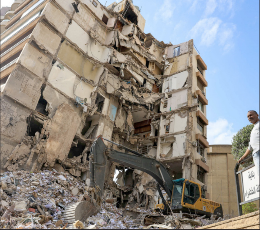
دمار لحق بمبنى إثر غارات على منطقة نزة الخياط وسط بيروت
